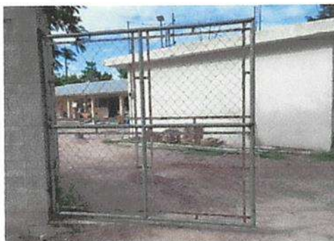
Foto 2: Se necesita reparar el porton de ingreso
